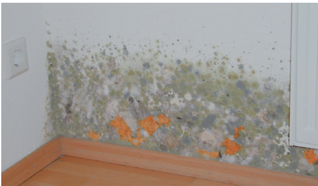
Massiver Schimmelbefall an Außenwand
